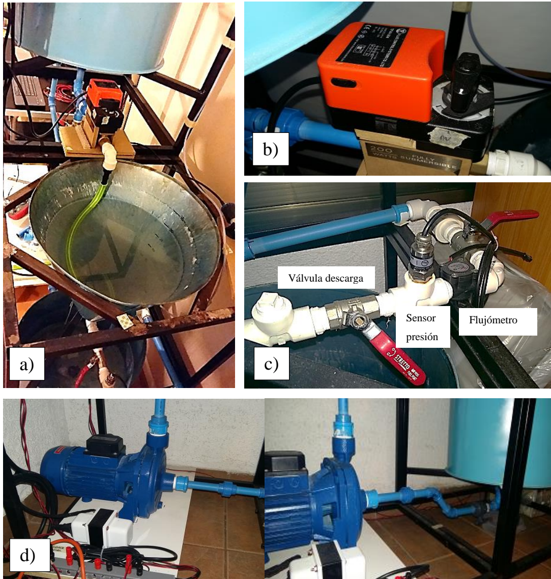
Figura 6.22. Vistas diversos componentes de la planta a) Vista superior de la planta de estanque cónico b) Válvula de control proporcional c) Sensor de presión, sensor de flujo y válvula manual d) Vistas bomba centrífuga
