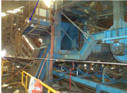
Chute de Descarga (Escotilla para ingreso al interior del chute)
