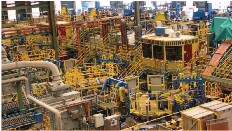
Figura 6: Vista aérea de sala de máquinas y grupo de 4 despegadoras de cátodos.
